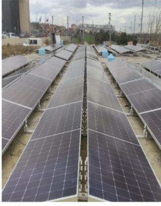
S.PAŞA 2.500 M3 DEPO GES (60 Kw)
