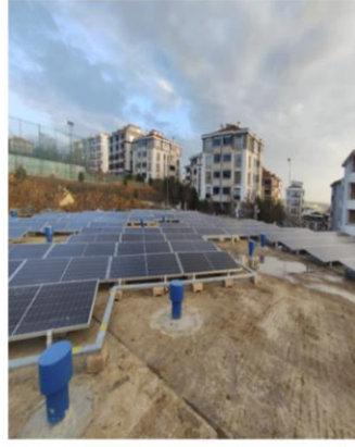
S.PAŞA 5.000 M3 DEPO GES (60 Kw)
