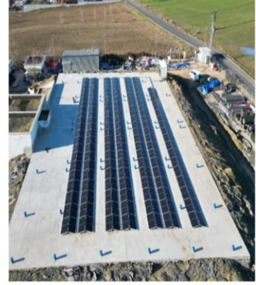
S.PAŞA 10.000 M3 DEPO GES (140 Kw)
