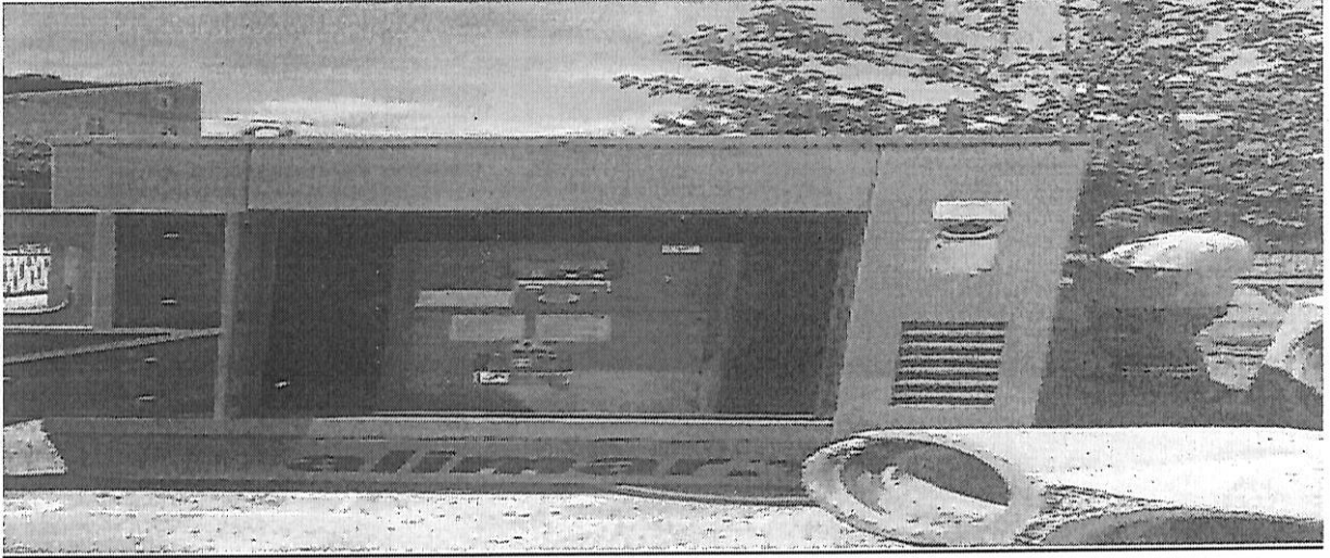
Fotoğraf 8. Ergene İlçesi Sağlık mahallesinde ki su kuyusunda bulunan jeneratör
